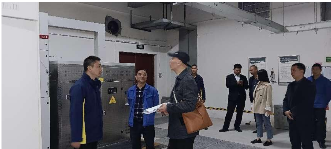
专家组一行检查配电室设施设备运行安全
